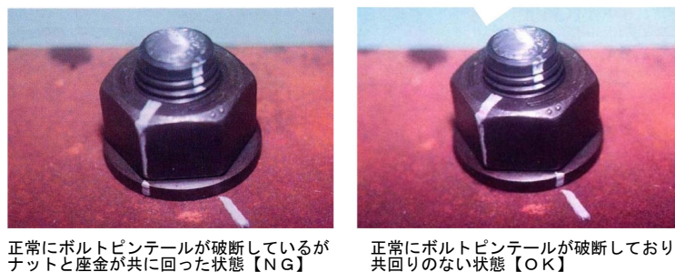
図-1 ボルトの供回り
