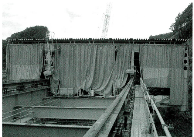
写真-3 防風カーテンの設置状況
