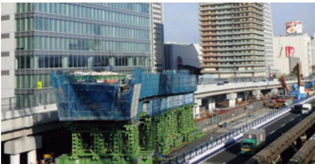
写真-5 ベント設備（既設上り線）
