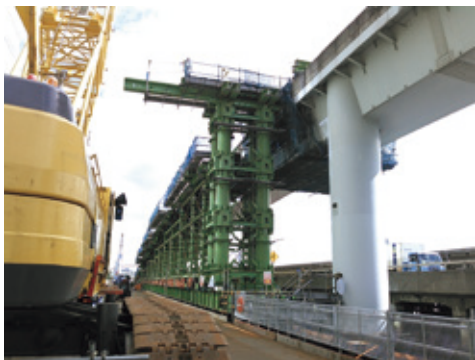
写真-1 ベント設備
