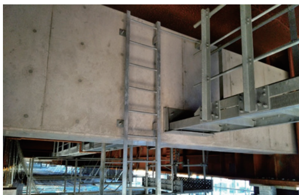
写真-1 現地の設置状況
