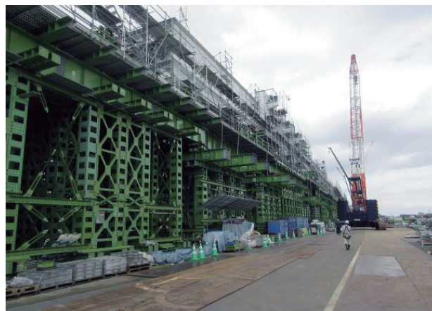
写真-4 軌条設備
