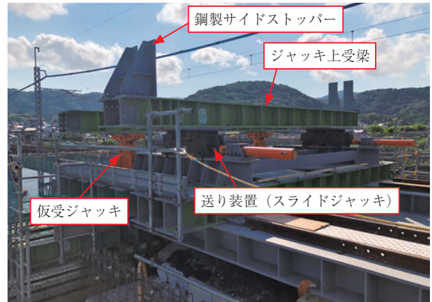
写真-1 送出し設備 (A1送り装置)
