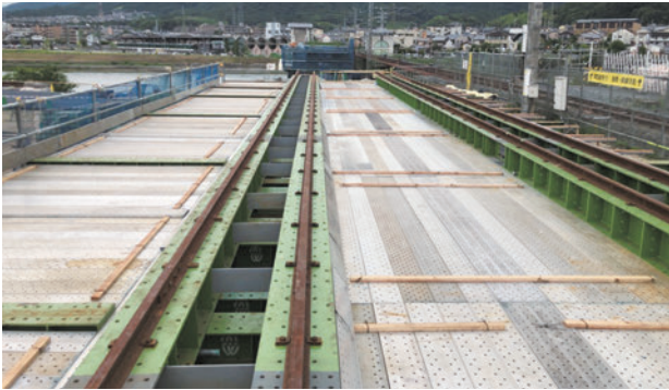
写真-6 軌条設備
