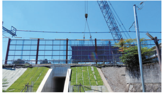
写真-7 線路防護設備
