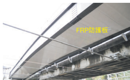
FRP防護板 山本陸橋（鉄道こ線橋） (和歌山県広川町 平成25年度竣工)
