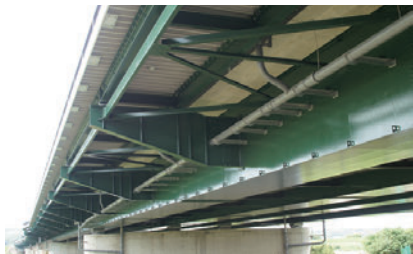
新名神高速道路 木津川橋他3橋 (NEXCO西日本 平成27年度竣工)
