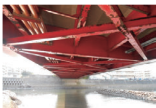
河川の消波ブロックからの海水による桁腐食
