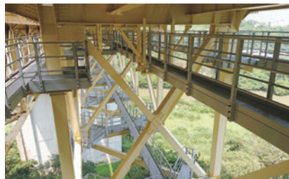
福地川橋上部工検査路 (トラス橋への設置) (NEXCO西日本 平成30年度竣工)
