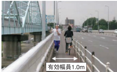
歩道の必要幅員が確保されていない橋梁例1
