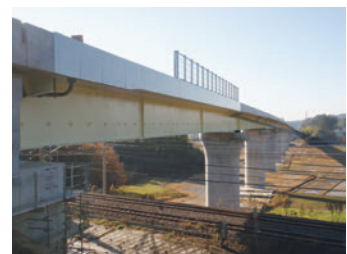
大網白里高架橋 (送り出し架設への適用) (NEXCO東日本 平成23年度竣工)
