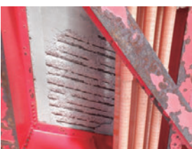
床版下面の海水による塩害損傷
