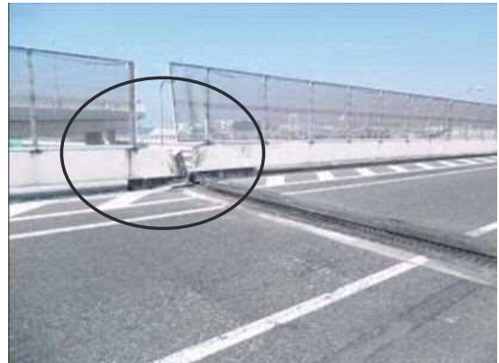
写真三 大P206橋脚の被災状況（路面の段差）
