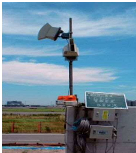
写真-5 レーザー式警報機
