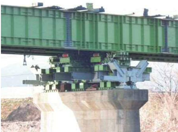
写真-11 橋脚上設備
