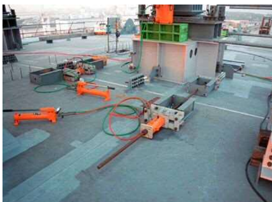
写真-4 仕口調整設備 (DECK)
