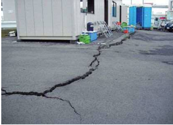
写真一 橋脚周辺地盤の液状化
