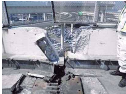
写真四 大P206橋脚の被災状況（拡大写真）
