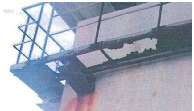
写真-2 歩廊が腐食して使用できない鋼製検査路
