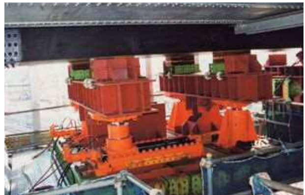
写真-14 現在の送り出し設備
