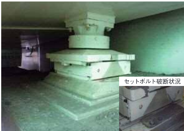
写真二 横湾P90橋脚の被災状況
