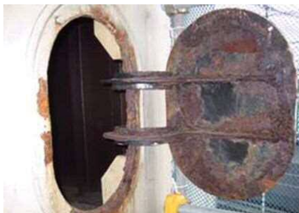
写真一9 錆付いた鋼製マンホールの事例
