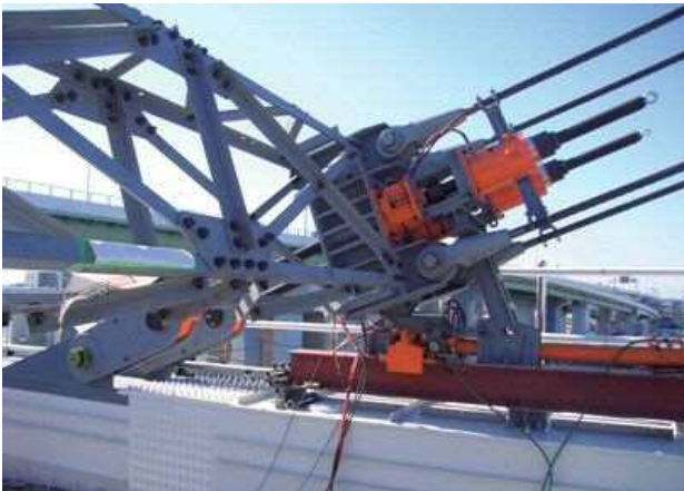
写真-3 引き込み設備
