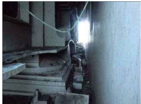
写真五 大P206橋脚の被災状況（ゲルバー部）
