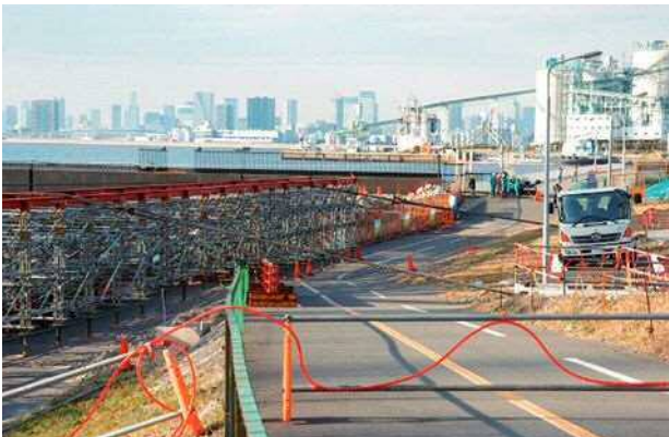
写真-7 ワイヤー防護設備
